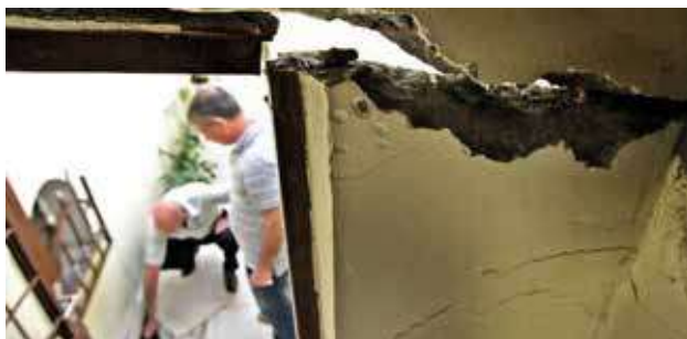
Rachaduras e danos estruturais em imóveis vizinhos a locais submetidos a rebaixamento forçado do lençol freático. Situações mais comuns em áreas baixas aluvionares com nível freático próximo à superfície
