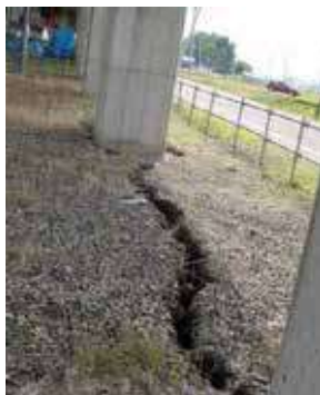
Danos estruturais provocados por horizontes de solos colapsíveis
