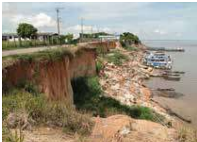
Terras caídas. Parintins – AM. Foto: CPRM
