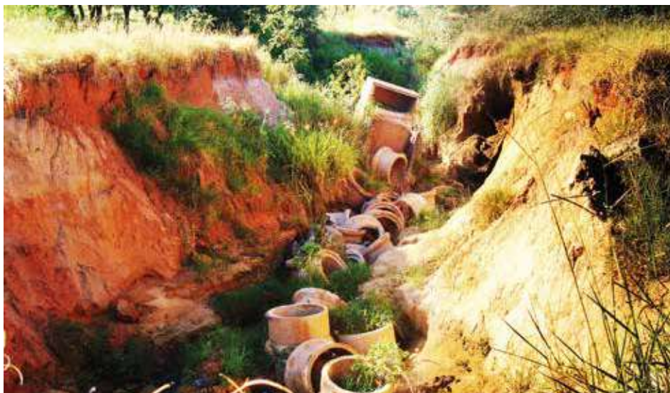
Idem. Colapso geral e erosão remontante ativada por sistemas de drenagem mal concebidos e executados. São José do Rio Preto (SP). Foto: G. Salviano
