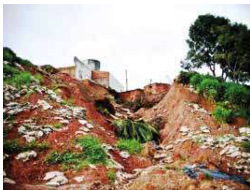
Processos erosivos remnantes decorrentes de falta de cuidados no lançamento de águas pluviais e esgotos urbanos
